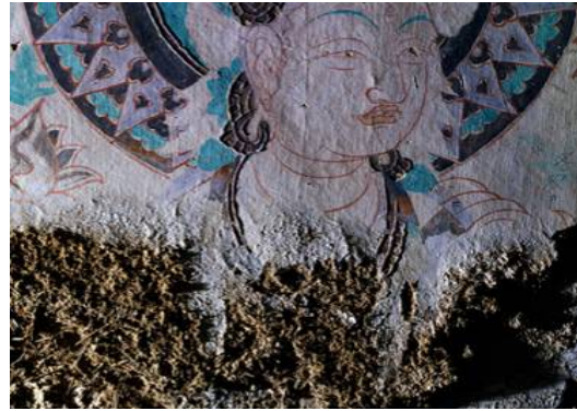
(d) Efflorescence (Cave 55).
